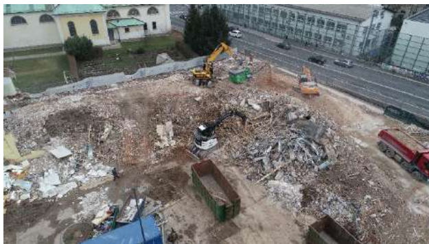
SLIKA 8: RUŠEVINE PODRTEGA OBJEKTA NA SV DELU IZKOPNEGA POLJA (POGLED PROTI SV).
