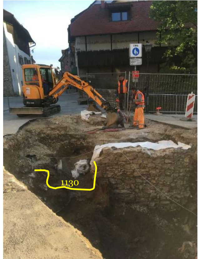
Slika 37: Zid SE 1125, prebit z vkopom za vodo. V ozadju vidna lokacija severnih poljanskih vrat (pogled proti s)
