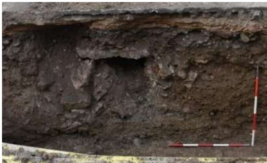
Slika 17: Delno porušen Kanal 2 na Severni strani izkopa (pogled proti s)
